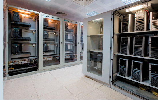
Schalttafeln des Prozessleitsystems
