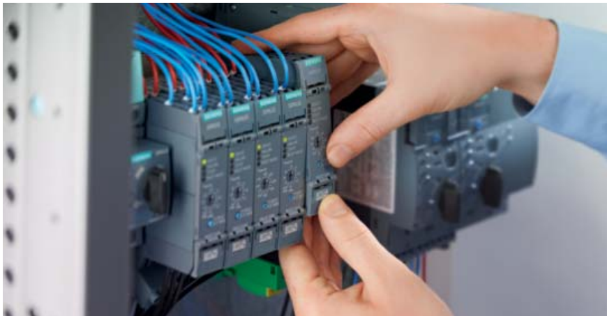
Bild 3 | Die im Schaltschrank eingesetzten elektrotechnischen Komponenten müssen für den Export in die USA entsprechende UL-Zertifizierungen aufweisen.
