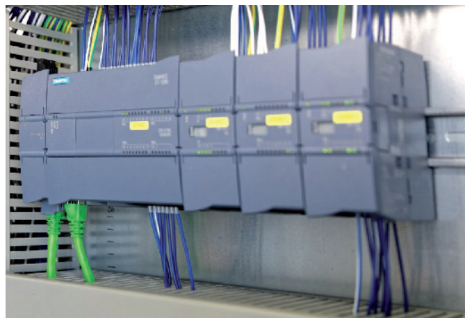
Der Controller Simatic S7-1200 kann mit Hilfe des Kommunikationsprozessors CP 1243-8 IRC (links) nahtlos an das vorhandene Fernwirkssystem angebunden werden.
