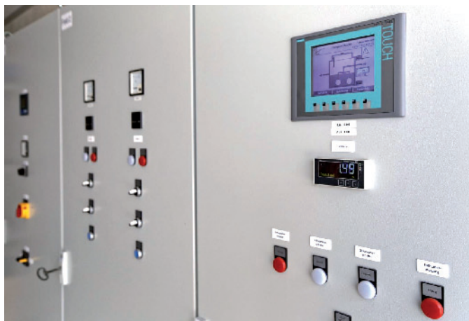
Das Touchpanel ermöglicht die einfache Bedienung und Beobachtung vor Ort.
