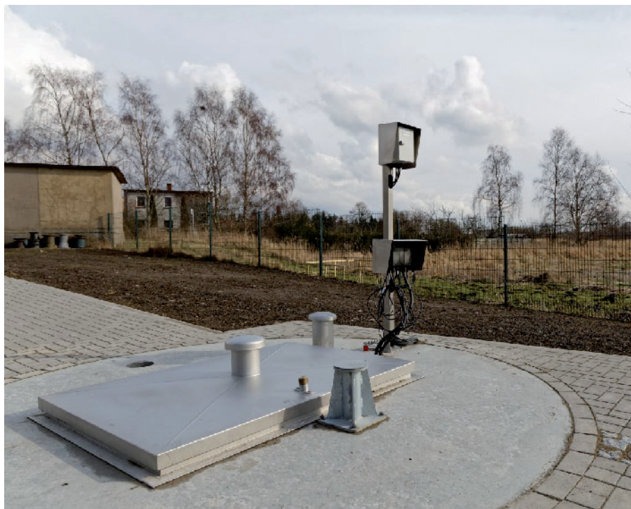
Der Standort in einem Wasserschutzgebiet macht eine besondere Pumpenüberwachung dieser Station nötig.
